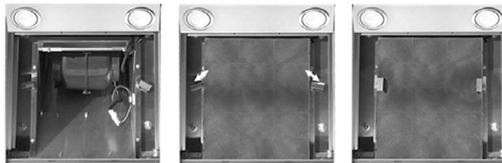
Obr. 11. Výměna uhlíkových filtrů instalovaných těsně před turbínou (kazety)
