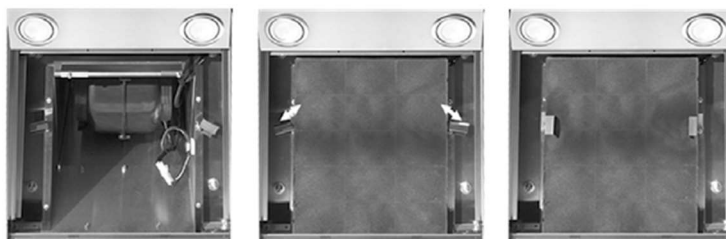
Obr. 12. Výměna uhlíkových filtrů instalovaných těsně před turbínou (kazety)
